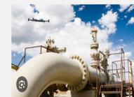
Giám sát thiết bị đường ống
